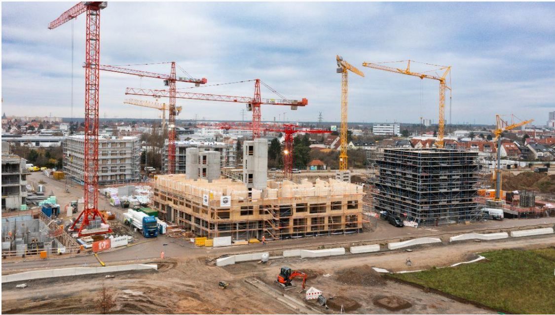
Das Bauen mit Holz ist in Deutschland schwieriger als der konventionelle Bau. Baden-Württemberg legt seit Jahresbeginn vor und stößt mit der HolzBauRL die Tür für den Holzbau weit auf. Foto: Imprinzip
